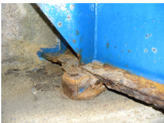
支承の機能障害
