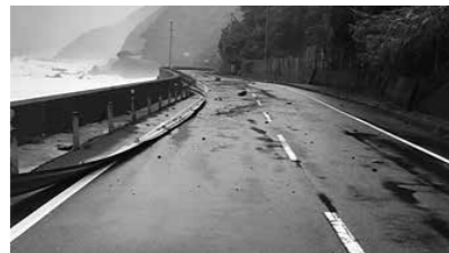
野根（ガードレール等、道路施設も損傷）
