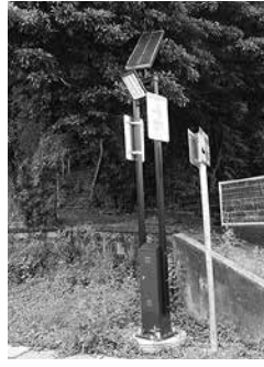
津波避難誘導灯
