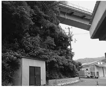
甲浦大橋 落石現場
