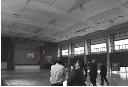
野根中学校 アスベスト状況
