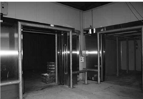
活用されていない冷凍施設
