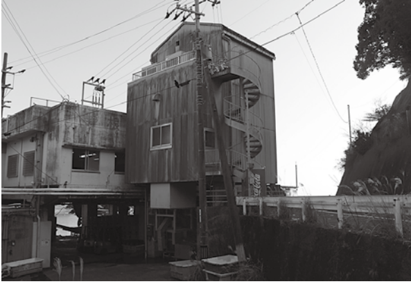
老朽化している製氷施設
