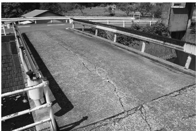
ひび割れがある小池小橋 ※点検の結果、通行には支障なし。
