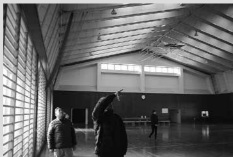
雨漏り箇所を確認する監査委員
