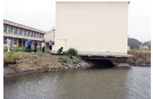
東松島市 中学校津波により基礎下流出
